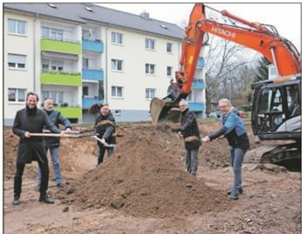
Schwungvoll: Frühspurt betreiben Bürgermeister Alexander Uhlig (rechts) und GSE-Vertreter beim ersten Spatenstich.
